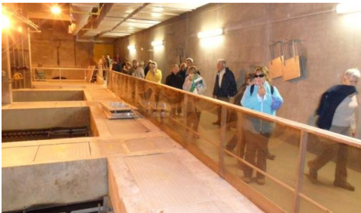
Passage à proximité des bassins de décantation...
