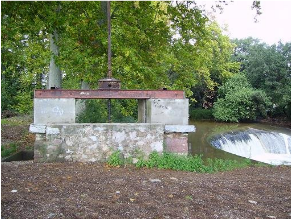
Le débit de l'eau peut être régulé par des vannes à la Castille
